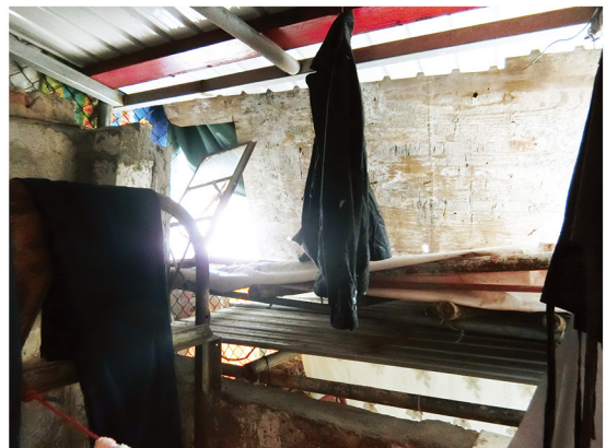
◀ 玻璃窗也被吹掉，仍待維修
