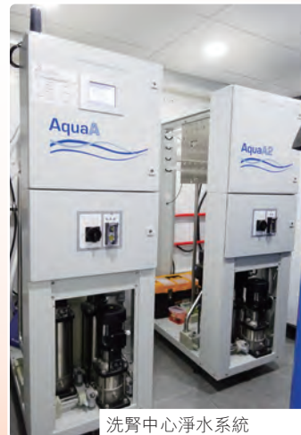
洗腎中心淨水系統 Water distribution system
