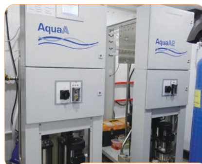
洗腎中心淨水系統 Water distribution system
