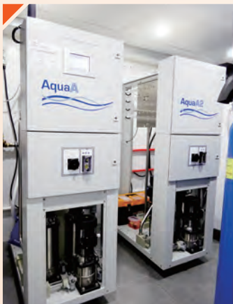
洗腎中心淨水系統 Water distribution system
