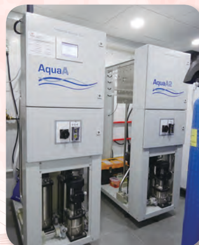
洗腎中心淨水系統 Water distribution system
