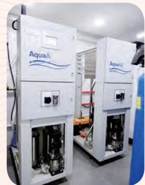
洗腎中心淨水系統 Water distribution system
